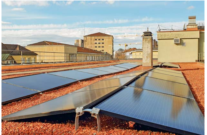
Aufgestellte Photovoltaikanlage auf dem Dach der kantonalen Verwaltung. Quelle: AWEL
